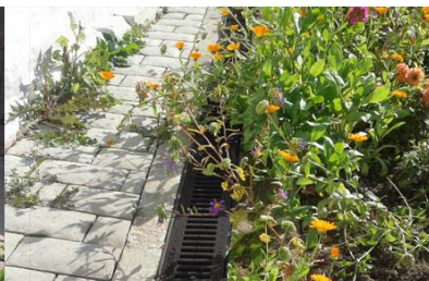
Отвод вод на отмостках домов и садовых дорожках
