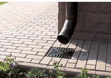
Отвод вод от водосточных труб
