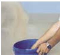
11 Per i rivestimenti esterni fissi lo strato di usura viene cosparso di sabbia quarzosa.
