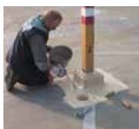
3 In primo luogo vengono impermeabilizzati tutti i dettagli con Triflex ProDetail e ...
