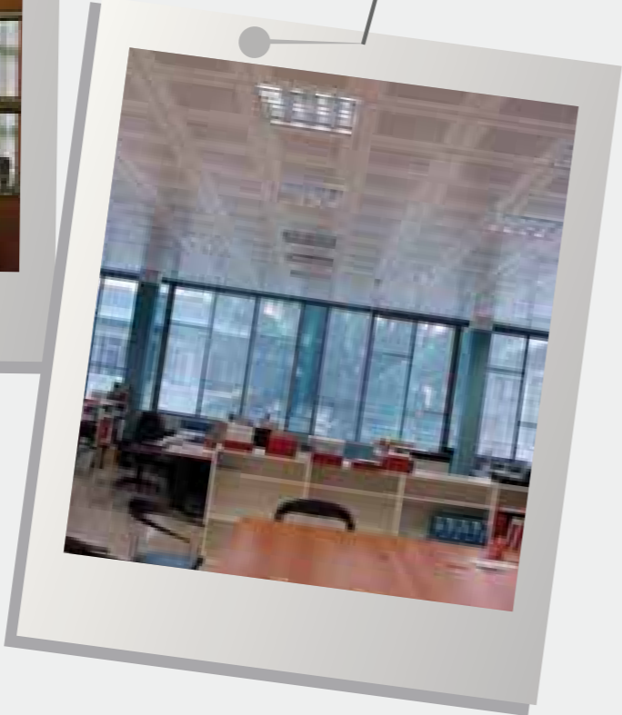
Ristrutturazione uffici, Brescia Riscaldamento e raffrescamento a soffitto sistema b!klimax a quadrotti 600x600
