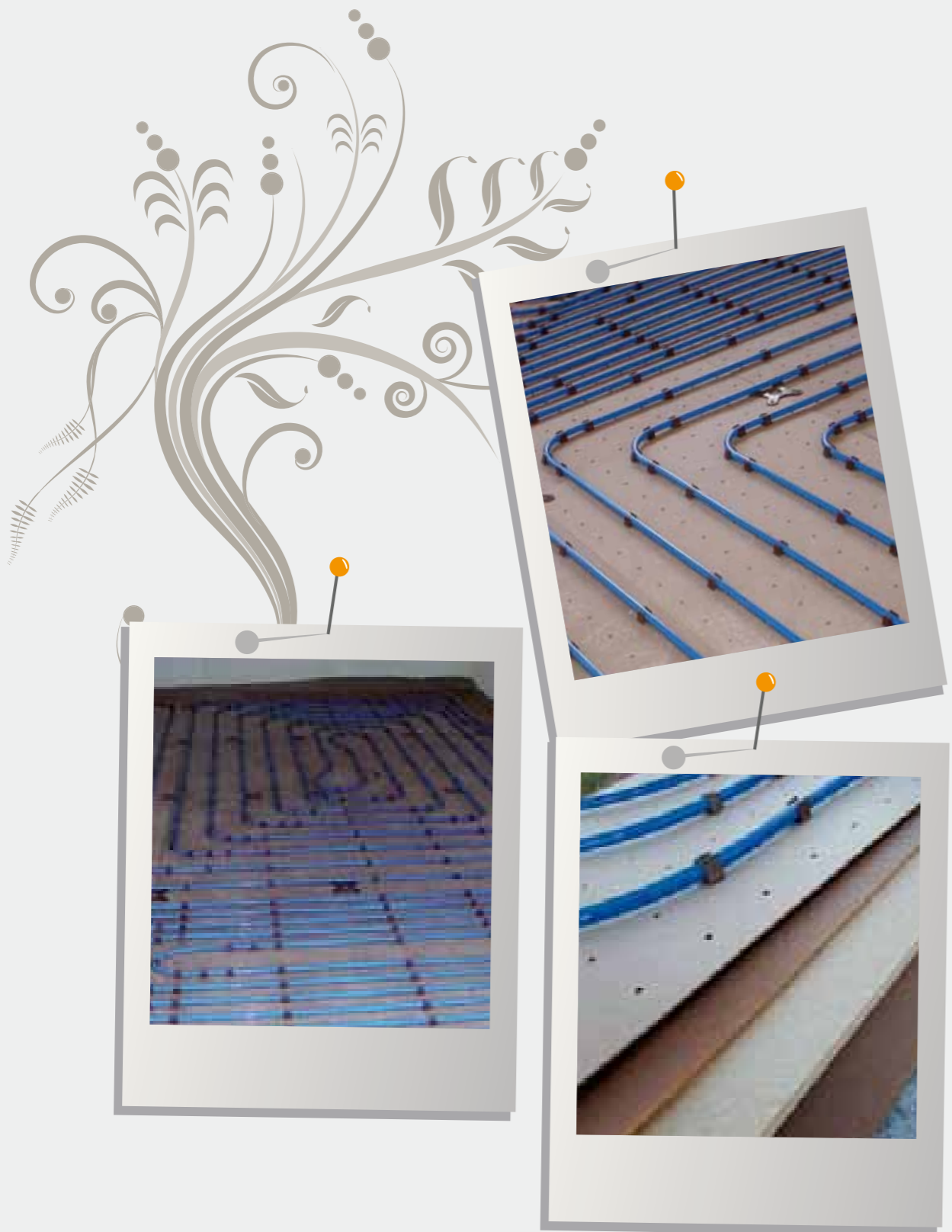
Abitazione, Roma Riscaldamento a pavimento sistema Bio
