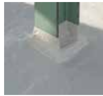
8 Alle Flächen sind sicher dicht bis ins Detail!
