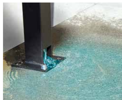
L'acqua piovana defluisce nei canali perimetrali e viene scaricata nelle colonne di sostegno
