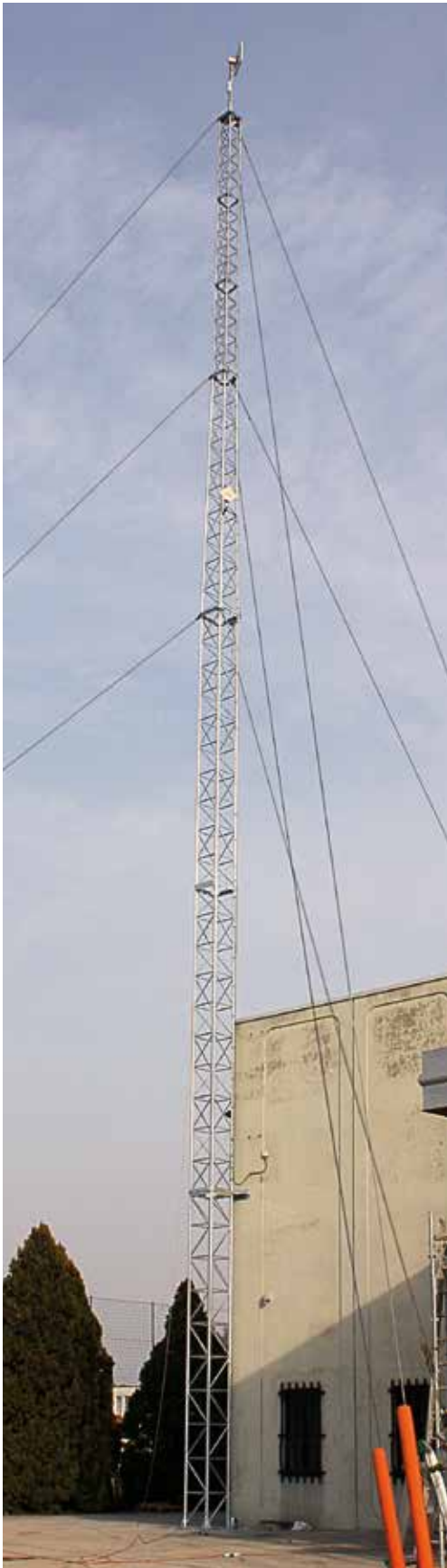
Colonna ponte radio Altezza 38 m, certificata per vento 130 km/h
